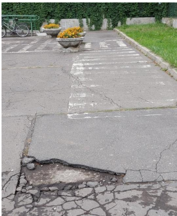
Zdjęcie nr 2. Trudno dostępna, nierówna nawierzchnia dojścia
