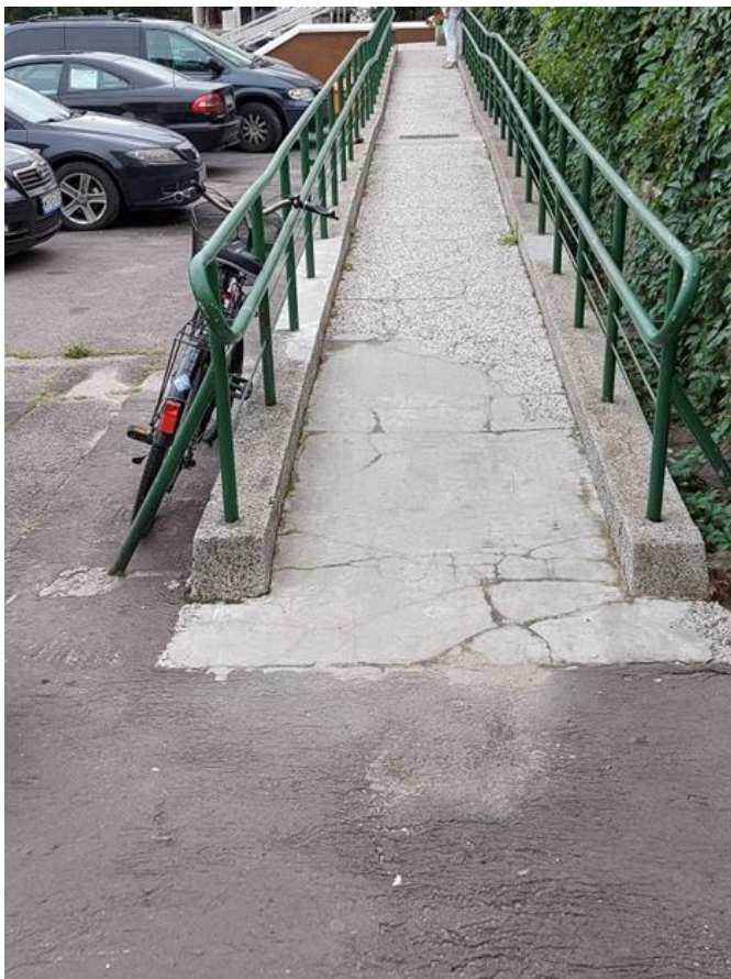
Zdjęcie nr 1. Pochylnia zewnętrzna niespełniająca standardów, ze zniszczoną nawierzchnią
