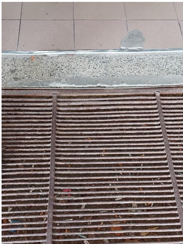
Zdjęcie nr 3. Wycieraczki przed drzwiami wejściowymi i za nimi, utrudniające dostęp osobom z niepełnosprawnościami
