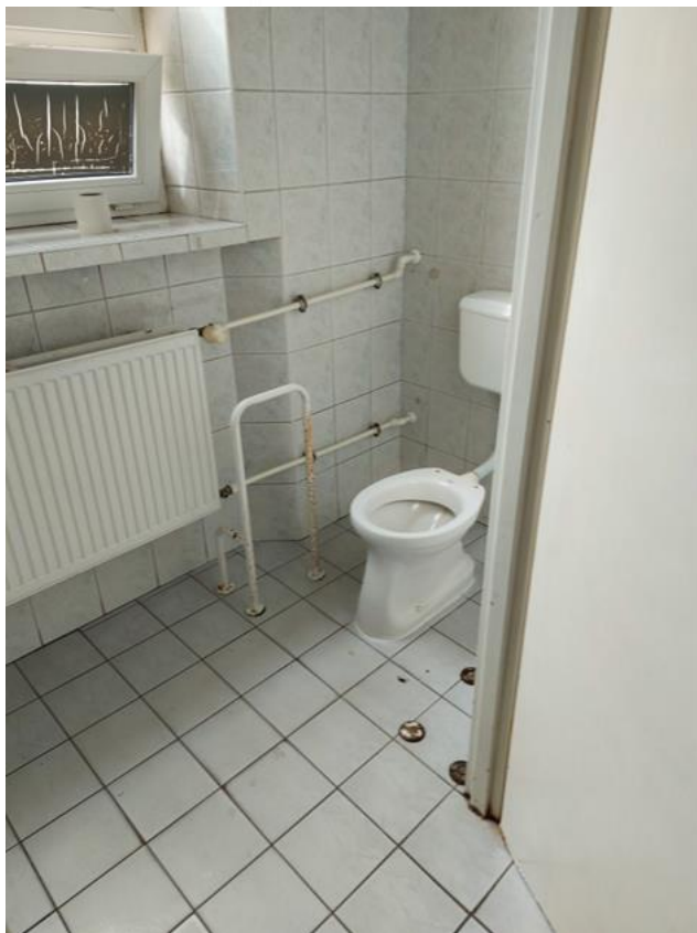
Zdjęcie nr 4 . Dedykowana toaleta przy holu głównym niespełniająca standardów
